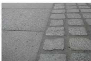
7. Zafugowana nawierzchnia brukowa
