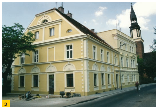
FOT. 1-2. Przykład renowacji zawilgoconego i zasolonego cokółu budynku – obiekt przed renowacją (1) oraz po jej przeprowadzeniu (2)
