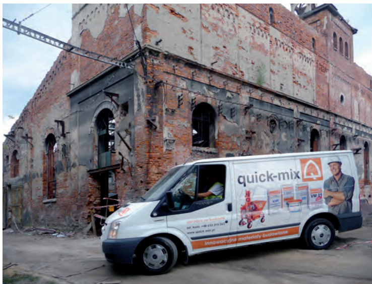
Elewacja budynku przed remontem. Uszkodzone tynki oraz detale architektoniczne.
