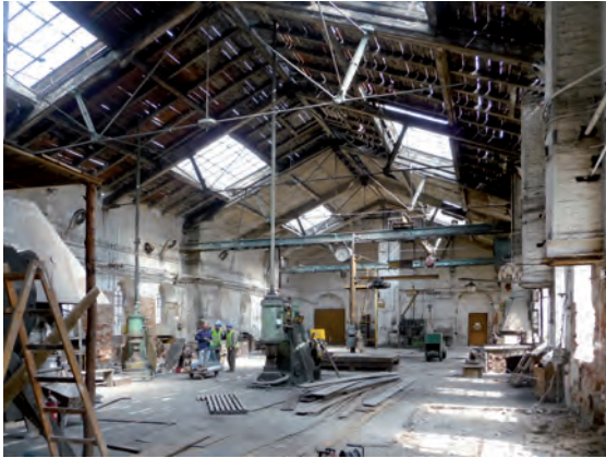
Hala warsztatów. Widoczna zniszczona drewniana konstrukcja dachu.
