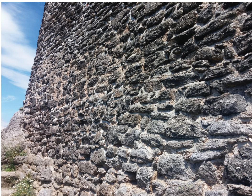
Mury zamku Chojnik przed remontem.
