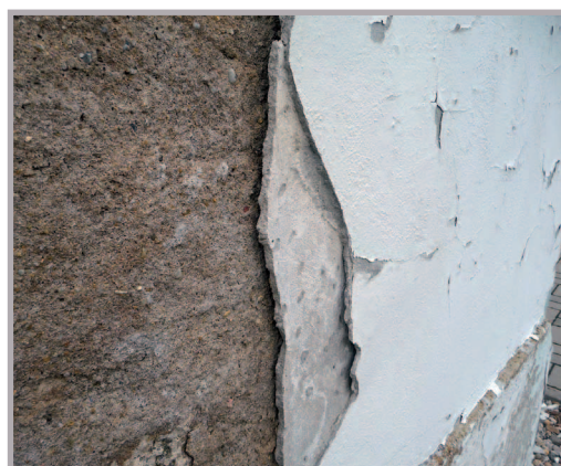
Mocny tynk cementowy ułożony na starym tynku wapiennym.
